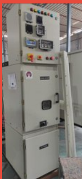
HT VCB breaker ABB
